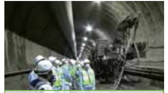
新幹線工事の現場見学を通じて、土木技術を体験的に学びます。
