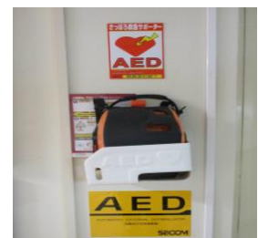
【職員室前廊下にあるAED】
