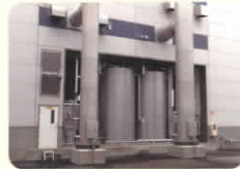
天然ガスボイラー
